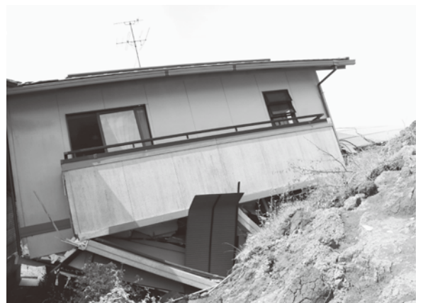
1階が土砂に押しつぶされ傾いた自宅
